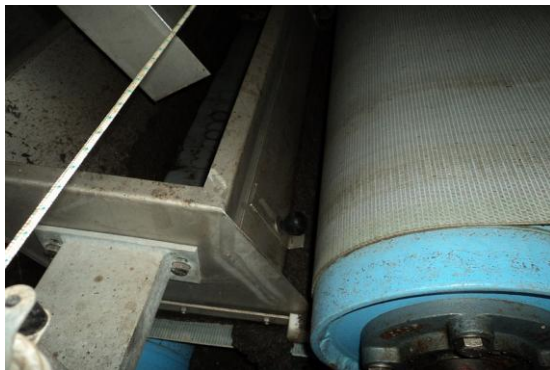
Foto 5. Tolva de entrada de fango espesado a filtro banda (16/10/13).
