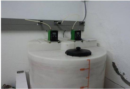
Foto 3. Bombas dosificadoras de hipoclorito (16/10/13).
