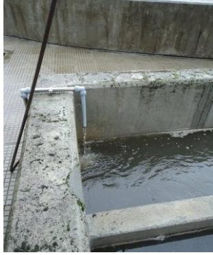
Foto 1. Punto de dosificación de hipoclorito na entrada ó labarinto de cloración (16/10/13).
