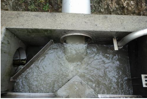
Foto 1. Entrada de auga previamente ó canal de desbaste (16/10/13).
